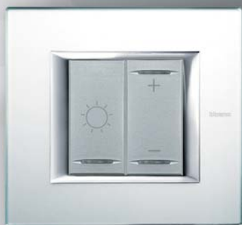
Comando radio iluminación dimmer
